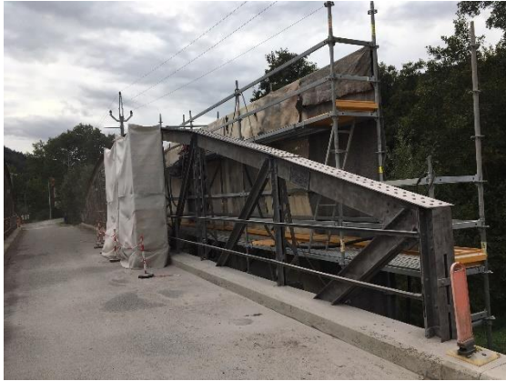
Příprava povrchu tryskáním
